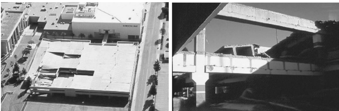
Fig. 12 Colapsul garajului etajat Northridge Fashion Center
