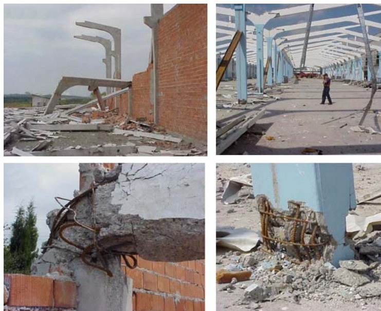
Fig. 8 Colapsul unei cladiri executate
